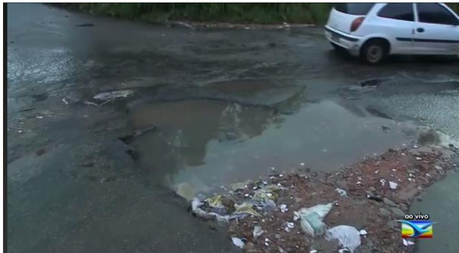
FIGURA 3. FALTA DE INFRAESTRUTURA NO BAIRRO DO BEQUIMAO - DS BEQUIMÃO.
