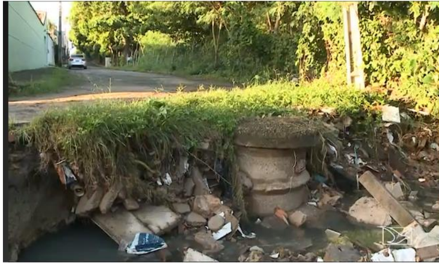
FIGURA 2. FALTA DE INFRAESTRUTURA NO BAIRRO DO COHAJAP - DS BEQUIMAO.
